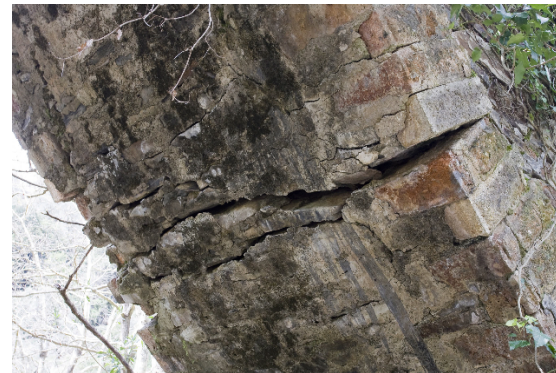
Βαθιές ρωγμές στο "σώμα" της γέφυρας, την καθιστούν επικίνδυνη για τη διέλευση των πεζών.
